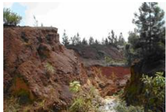
Fig 4: Socavamiento de la base del Talud provocado por escorrentía provenientes de cotas superiores
