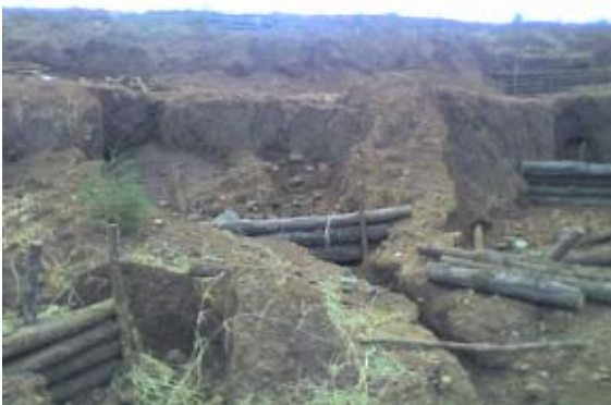
Fig 5: Taludes erosionados por la acción del agua
