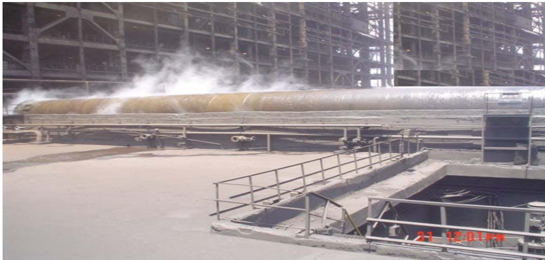
Figura. 1 Instalación destinada para el proceso de enfriamiento.
