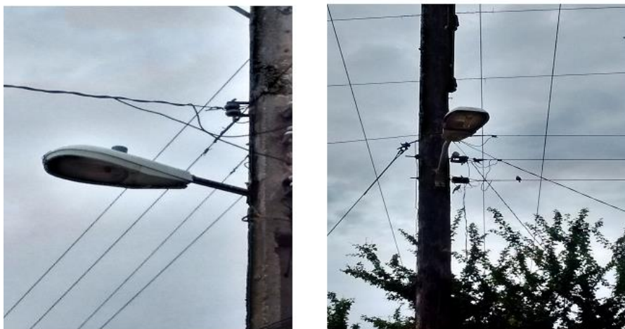
Figura 2.4 Muestra de las deficiencias del sistema de iluminación.
