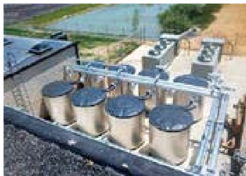
Fig. 1.1 Tanques de polietileno Icebank
