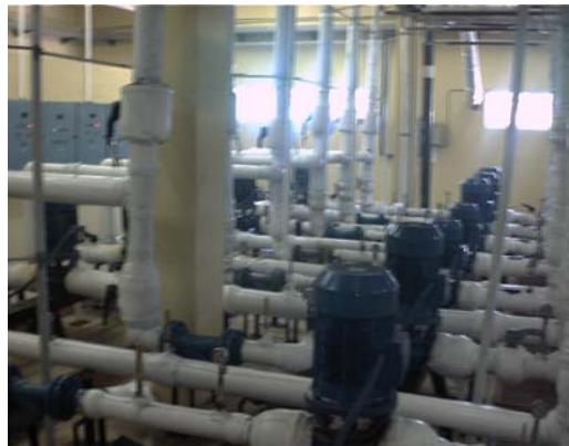
Fig. 2.2 Bombas del Circuito Secundario de Agua Fría.
