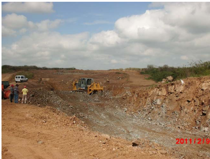
Foto No 6. Impacto sobre el medio ambiente por los trabajos de explotación.
