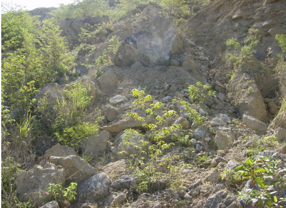
Foto 2.2.5 Bloques desprendidos de la pared del talud.
