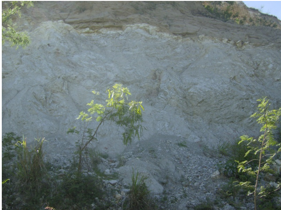
Foto 2.2.5 Base del talud formada por arcillas grises muy fracturadas
