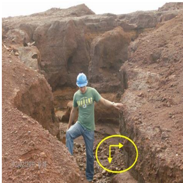
Foto 14 Cárcava profunda en dique norte de la presa de colas, Hernández, T. 2014
