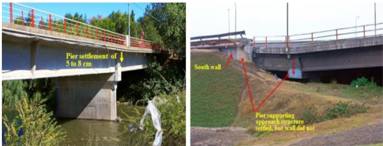
Figura 10: A la izquierda: Asentamiento del pilar central del Puente San Nicolás en la región de Bio Bio, Chile. A la derecha del Puente Juan Pablo II, Concepción, Chile, ambos caso se produjeron posterior al terremoto del 27 de febrero de 2010.
