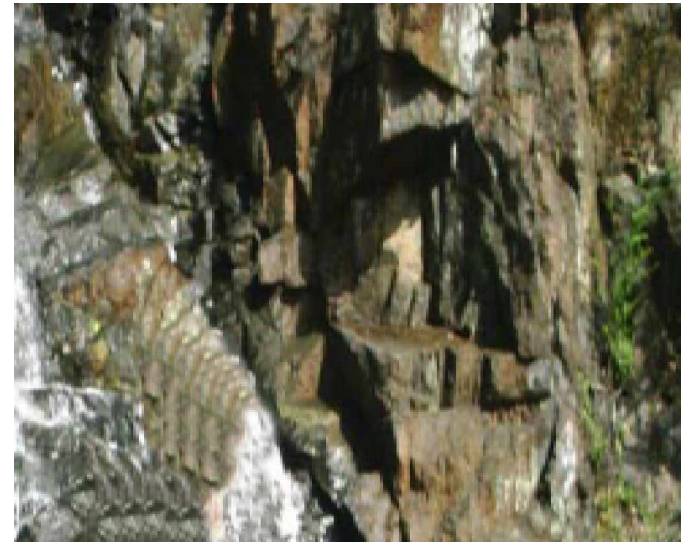
Deslizamiento en rocas
