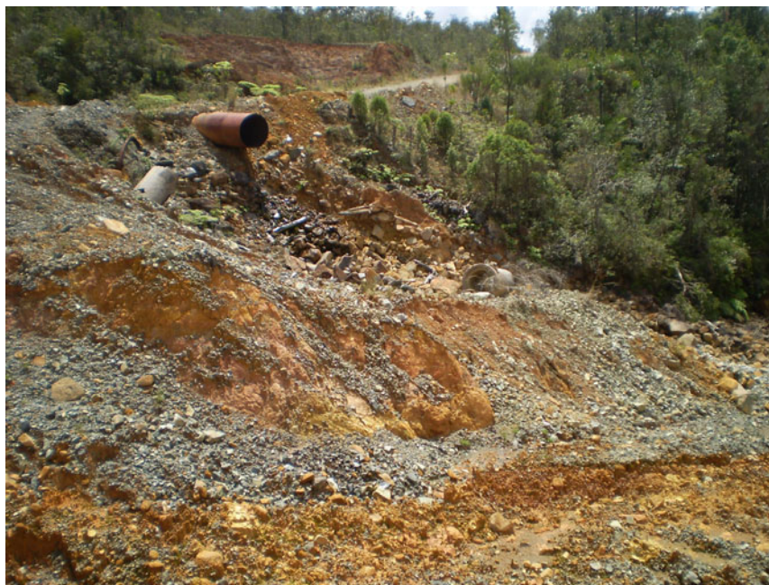
Foto 3.6. Deslizamiento rotacional y erosión (camino).
