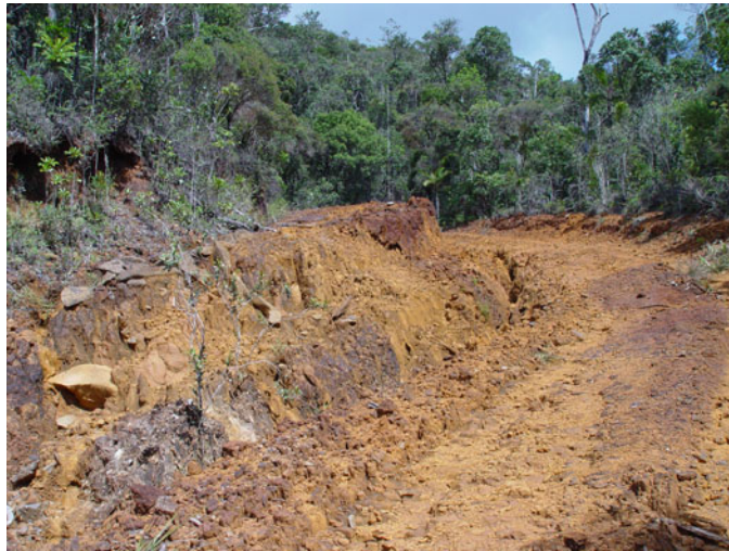
Foto 3.7. Procesos erosivos y pequeñas inestabilidades en laterales de caminos de primer orden.
