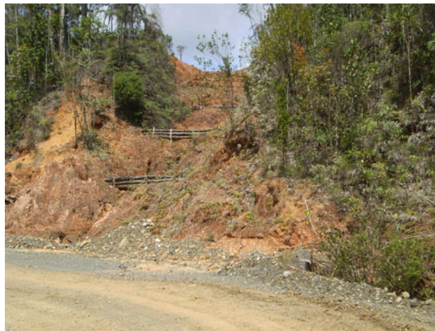
Foto 3.8. Erosión en cárcavas.
