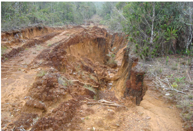
Foto 3.9. Acarcavamiento en caminos sobre cortezas lateríticas en bajas pendientes.
