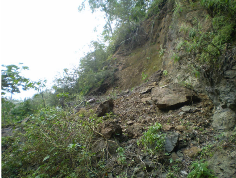
Foto 3.4. Desprendimiento de rocas.
