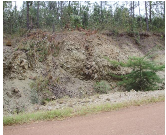
Foto. 2.4: Km 13+500 Serpentinita muy agrietada
