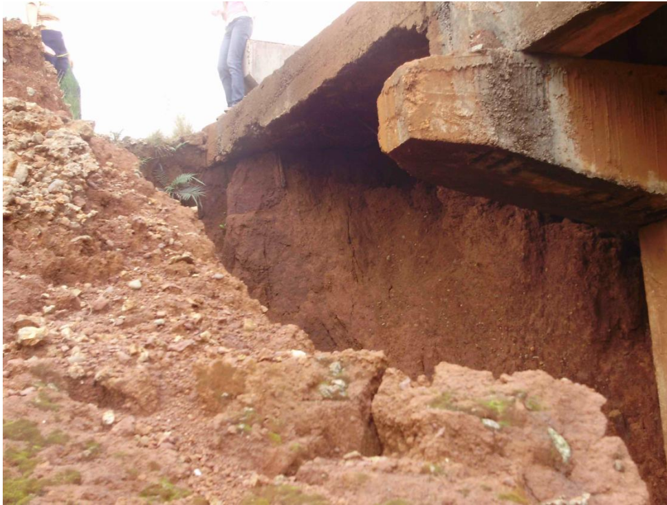
Foto 3.2: Proceso erosivo dado por el escurrimiento superficial
