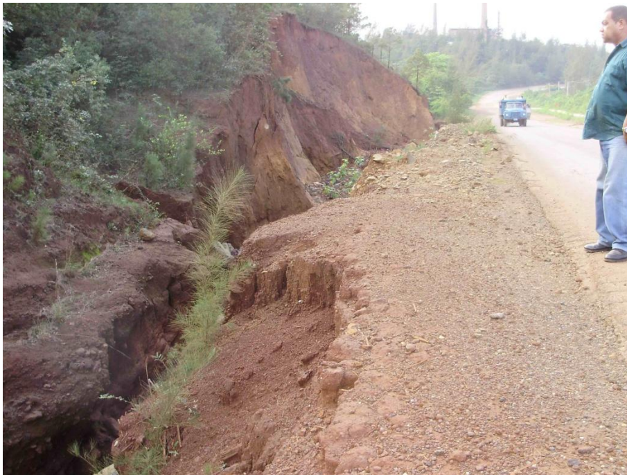
Foto 3.1: Erosión en cárcavas en las cercanías del puente Yagrumaje
