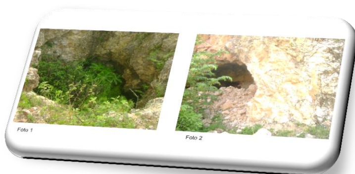
Figura 2.2. Cavernosidad en el Frente de Explotación al Norte y Este respectivamente en la cota 50.
